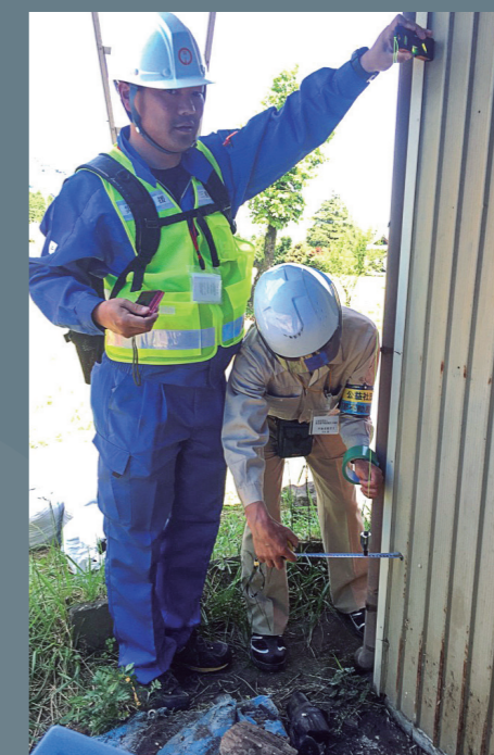
住家被害認定調査の様子
